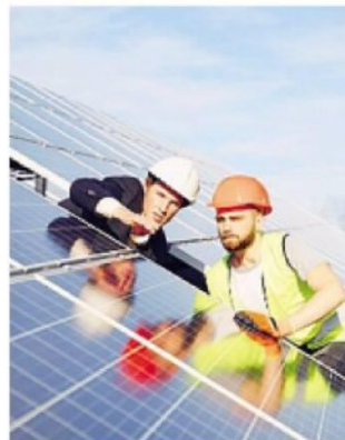
Un impianto fotovoltaico
